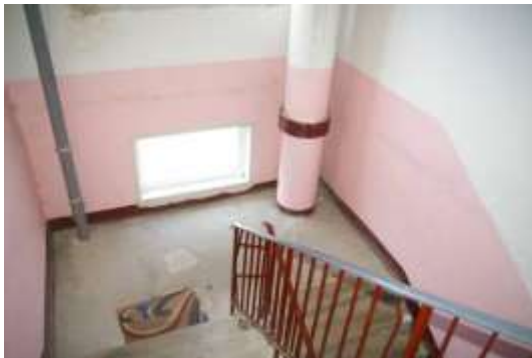
Būve ar kadastra apzīmējumu 1700 002 0247 007, koplietošanas telpa
